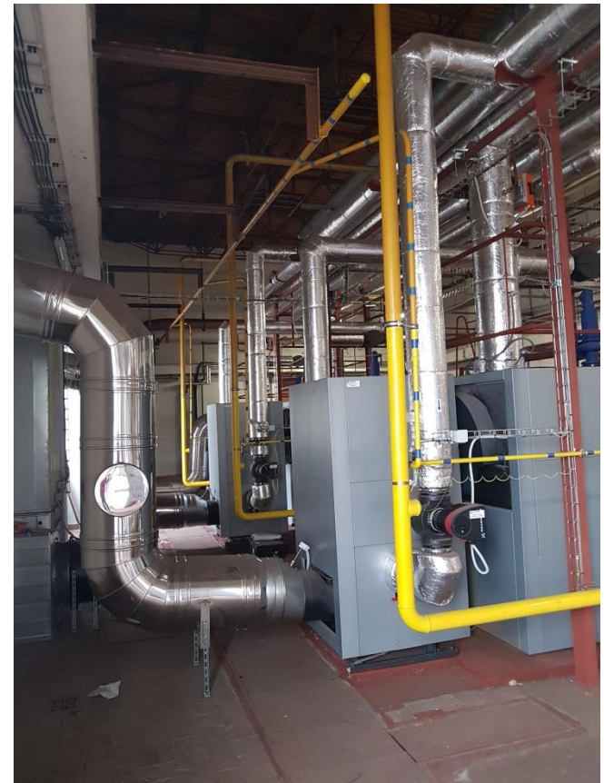
Spalinový výměník za teplovodním kotlem
